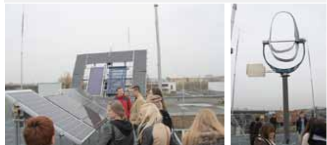
INSTALACJE ODNAWIALNYCH ŹRÓDEŁ ENERGII NA DACHU KATEDRY ENERGETYKI ZAWODOWEJ BTU C-S. (FOT. JUSTYNA JUCHIMIUK)
