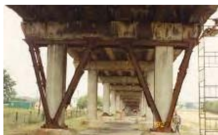
RYŚ. 12. TYPOWE USZKODZENIA MOSTÓW PREFABRYKOWANYCH WYBUDOWANYCH W LATACH 70 XX W. – WIDOCZNE SĄ SKUTKI NISKIEJ JAKOŚCI WYKONANIA.
