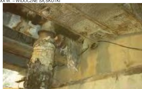
RYŚ. 13. USZKODZENIA WYWOŁANE ZŁYM UTRZYMANIEM MOSTU MIEJSKIEGO
