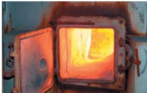
„PRZEDSIÓNEK PIEKŁA” WIDOK DO WNIĘTRZA JEDNEGO Z KOTŁÓW
