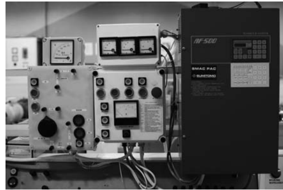
RYŚ. 3 WIDOK PRZEMIENNIKA CZĘSTOTLIWOŚCI I PANELU STEROWANIA STANOWISKIEM
