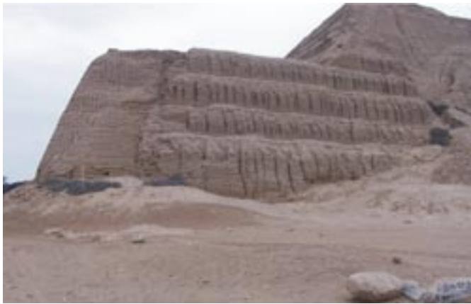
WSPÓŁCZESNA EROZJA PRAWIE 2000-LETNICH BUDOWLI WSKUTEK ODDZIAŁYWANIA PRĄDU EL NINO
